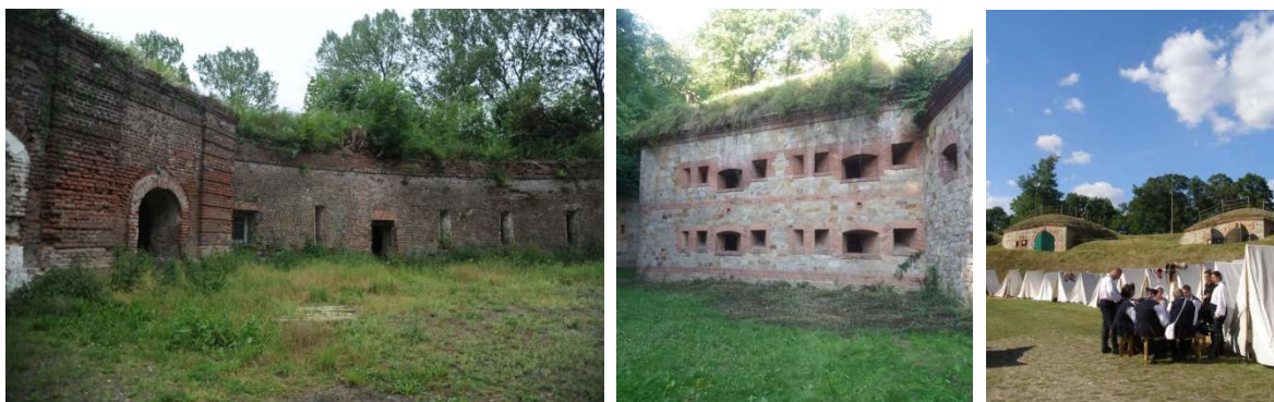
Stan zachowania nieużytkowanej Reduty Kardynalskiej, obok Fort II Regulicki – dobry stan zachowania, fort podczas Dni Twierdzy Nysa w 2017r., fot. I. Solisz
